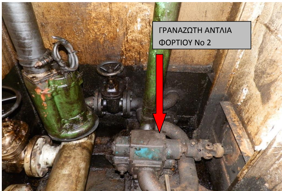
Εικόνα 4: Αντλία φορτίου εντός του αντλιοστασίου του πλοίου
